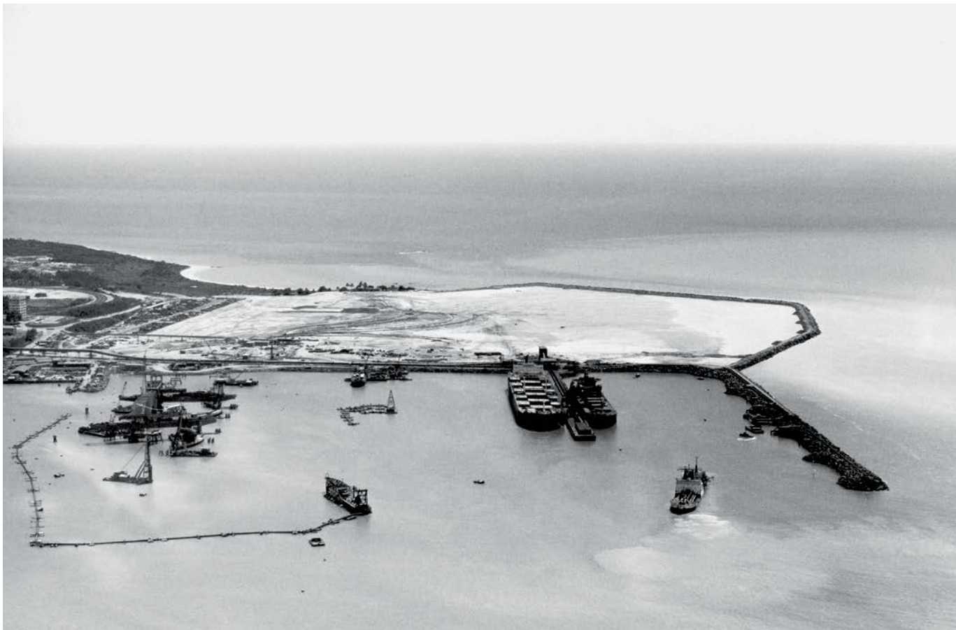
F11 Construção do porto de Tubarão, década de 1960. Acervo Centro de Memória da Estrada de Ferro Vitória a Minas, Museu Vale.
