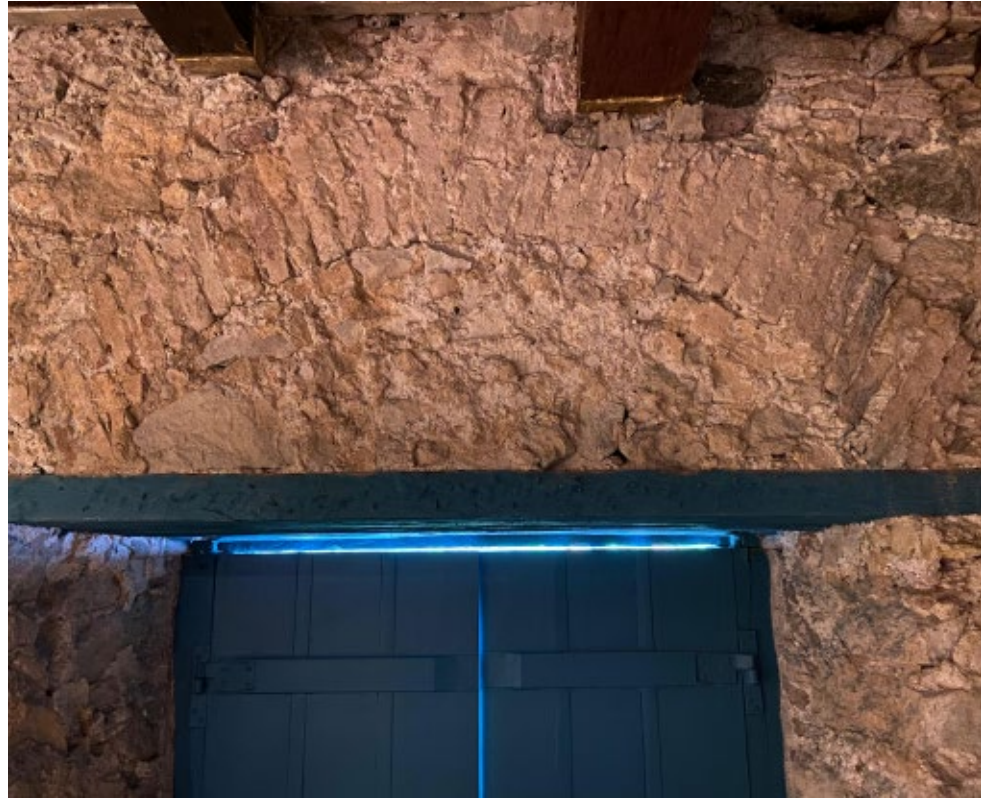
[Fig. 2] Arco de descarga construído acima da arquitrave da janela na Capela do Santíssimo. Foto da autora, 2023
